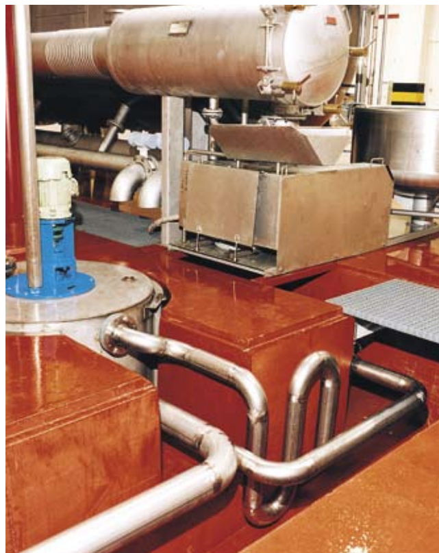
UCRETE® wird häufig zur Auskleidung von Abwasserrinnen, Auffangwannen, Pumpensäumpfen sowie Bodenflächen verwendet.
